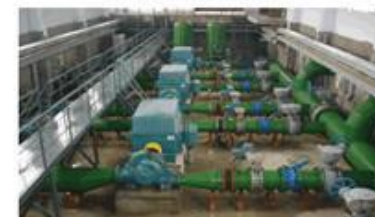
智能水泵设备
